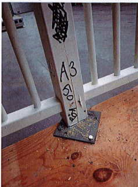
Foto 7: Beschadiging aan de VRIHÉSPIL (vervangen)
