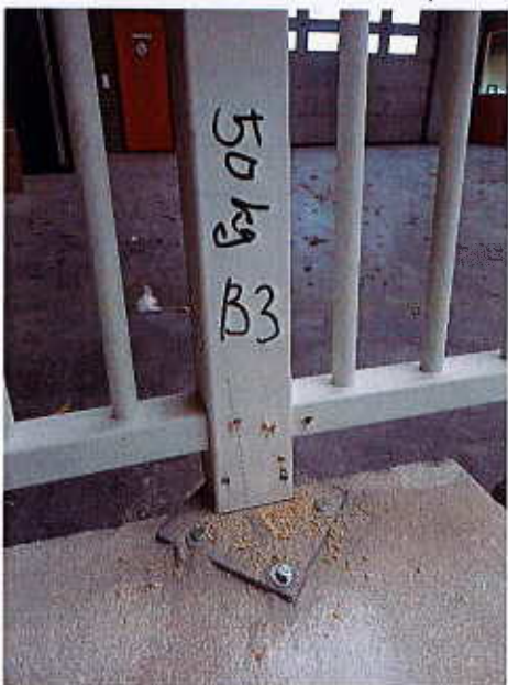
Foto 6: Beschadiging aan de VRIHÉSPIL (vervangen)
